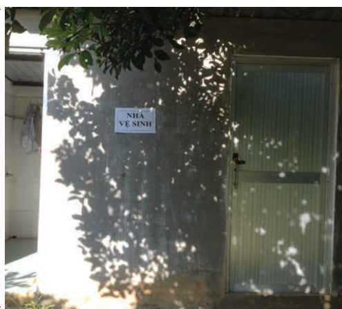
Hình 10. Nhà vệ sinh tự hoại
